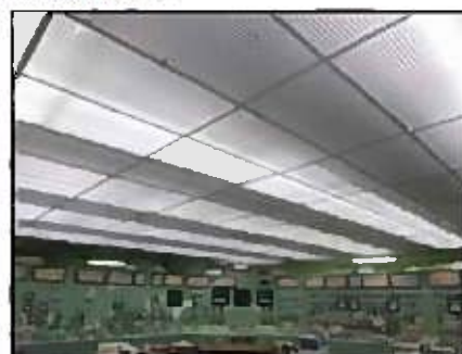
非常用照明点灯時 (常用照明消灯)
