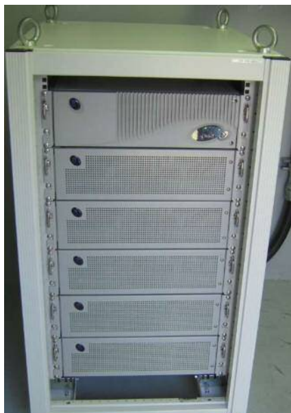
無停電電源装置
