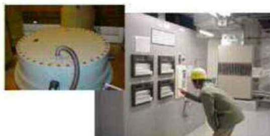
二重蓋間圧力監視(密封性確認)
