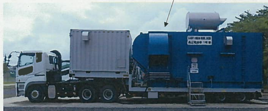
常設代替高圧電源装置 2-16
