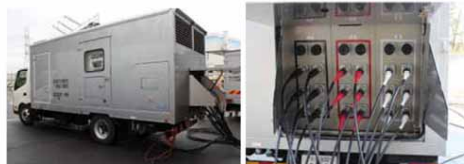
ケーブル接続箇所(低圧電源車側)
