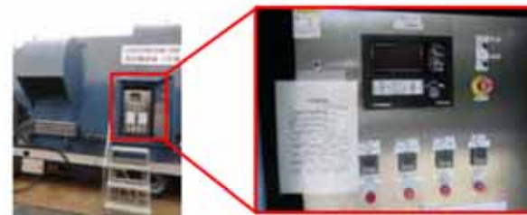
現場操作盤 (高圧電源装置)
