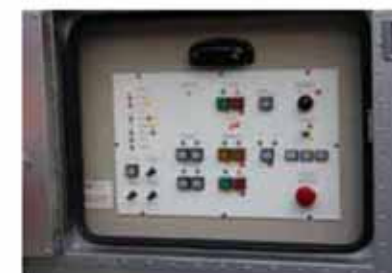
操作盤(低圧電源車)
