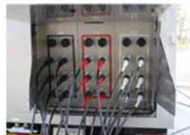
ケーブル接続箇所(低圧電源車)
