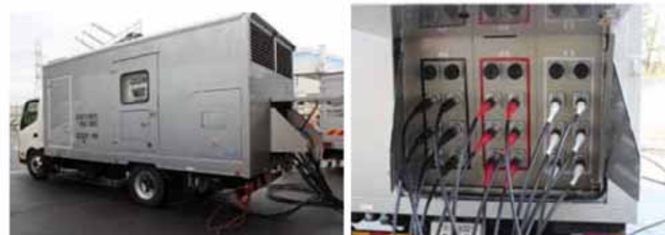
ケーブル接続箇所(低圧電源車側)
