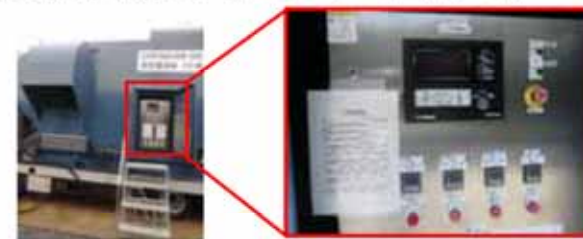
現場操作盤 (高圧電源装置)
