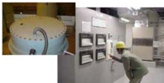
二重蓋間圧力監視(密封性確認)
