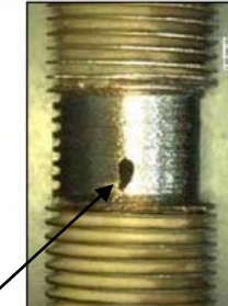
写真③ 主油冷却器(B) 伝熱管(1本) 漏えい孔
