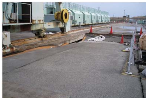
写真④:地盤の沈下状況(取水口エリア)
