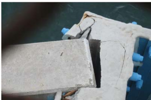
写真③: 躯体の変形
