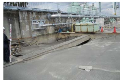
写真①:地盤の沈下状況(取水口エリア)
