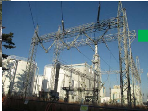
気中開閉所(取替前)
