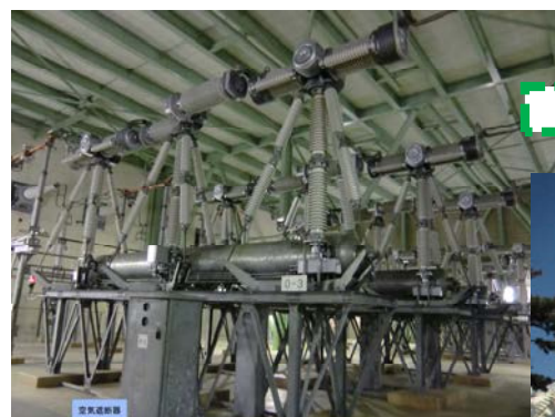
気中開閉所（取替前）
