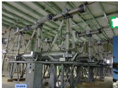
気中開閉所(取替前)
