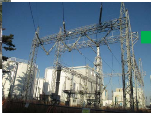
気中開閉所（取替前）
