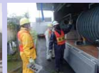
降雨時の電源車の設置・運用
