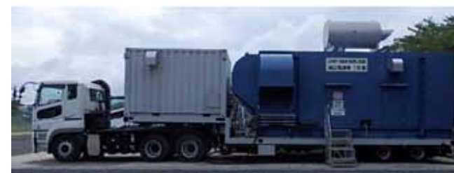
常設代替交流電源設備
