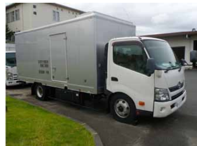
可搬型代替交流電源設備
