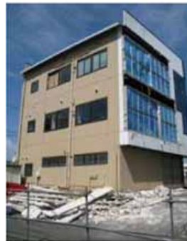
瓦礫は建屋周辺に堆積
