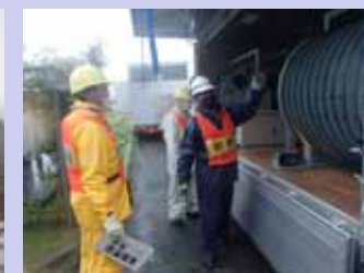
降雨時の電源車の設置・運用
