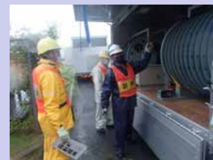
降雨時の電源車の設置・運用
