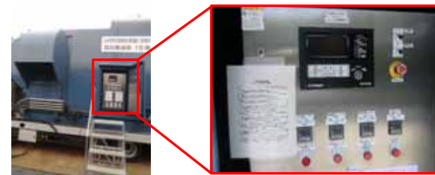
現場操作盤 (高圧電源装置)
