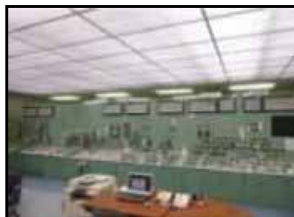
②原子炉補機及び 非常用炉心冷却系 制御盤
