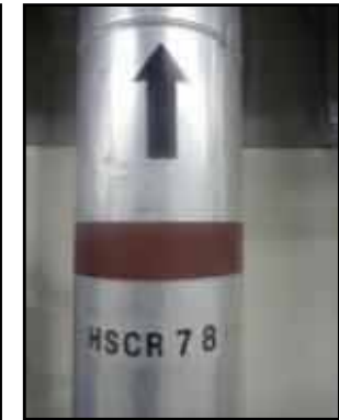
蒸気配管: 暗い赤 HSCR: 所内蒸気 復水戻り系
