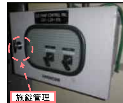
②現場盤の施錠管理
