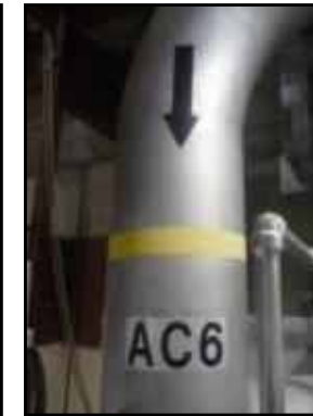
ガス配管: 黄 AC: 不活性ガス系
