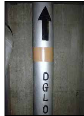
油配管: 暗い黄赤 DGLO: 非常用 ディーゼル 発電機潤滑油系
