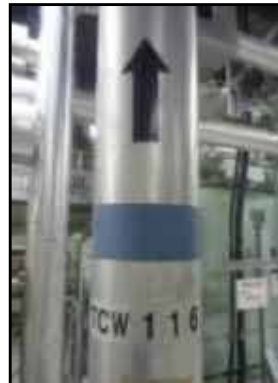
水配管: 青 TCW: タービン補機 冷却水系
