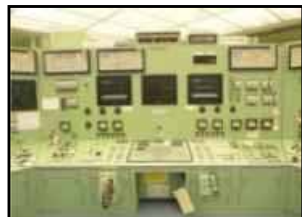
①原子炉制御盤
