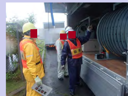
降雨時の電源車の設置・運用
