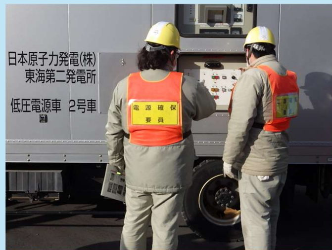
低圧電源車を起動する対応者
