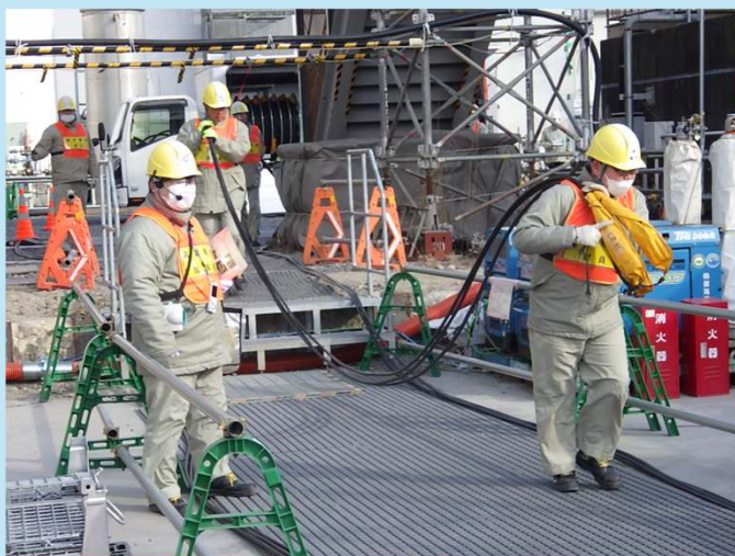
低圧電源車から原子炉建屋接続口へ ケーブルを運ぶ対応者
