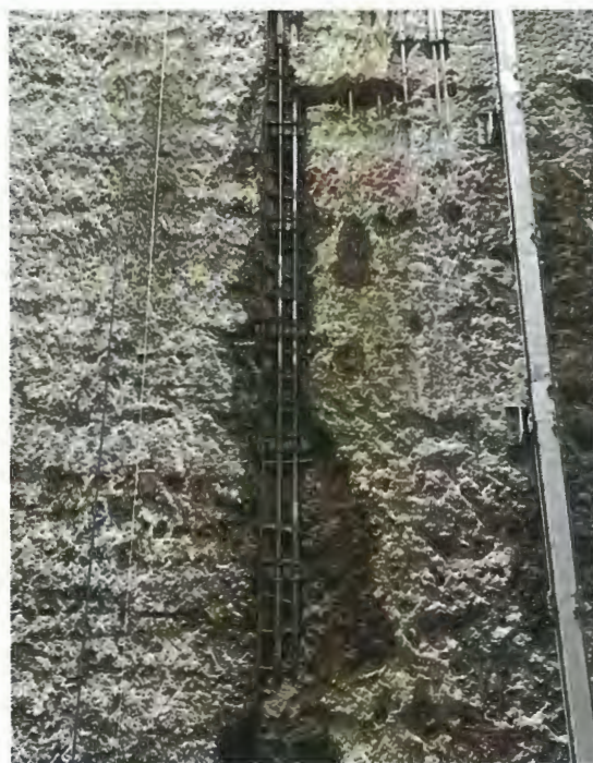
地中連続壁部の不具合箇所 (未充填部)
