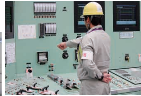
中央制御室での確認作業
