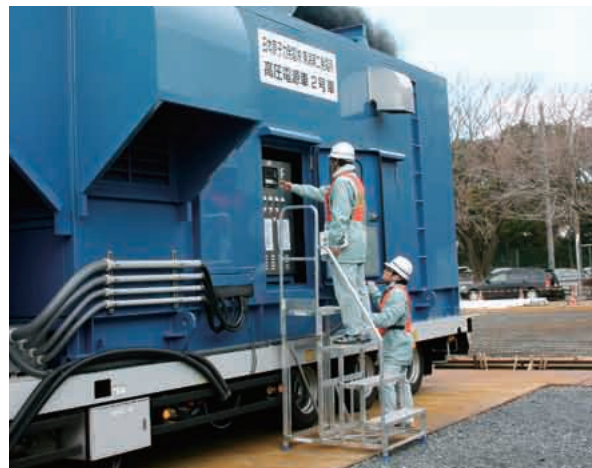
高圧電源車の起動訓練
