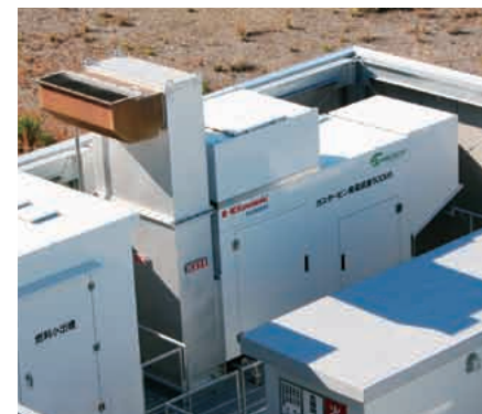
免震棟屋上のガスタービン発電装置
