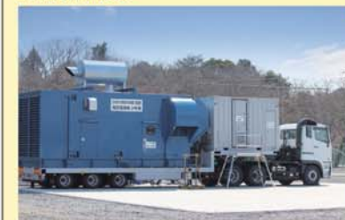
空冷式の高圧電源車
