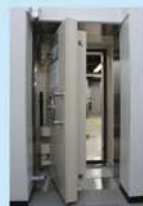
水密扉(開放状態)
