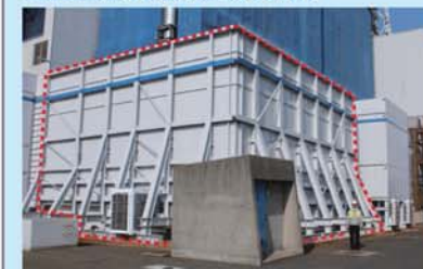
非常用ディーゼル発電機を設置した建屋への防護壁
