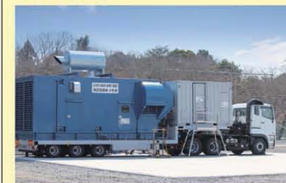
空冷式の高圧電源車
