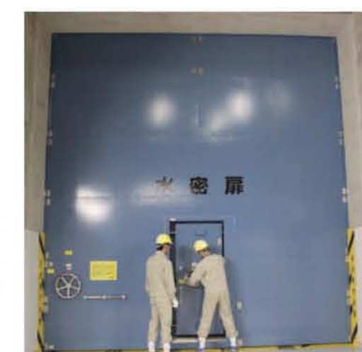
水密扉(閉止状態)
