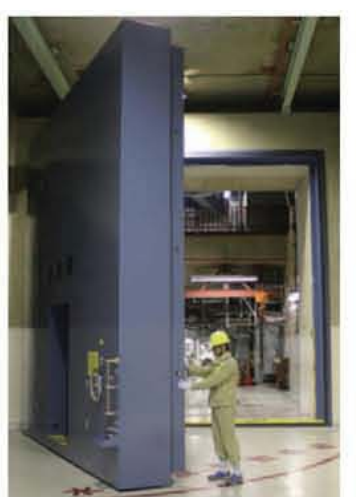
水密扉(開放状態)
