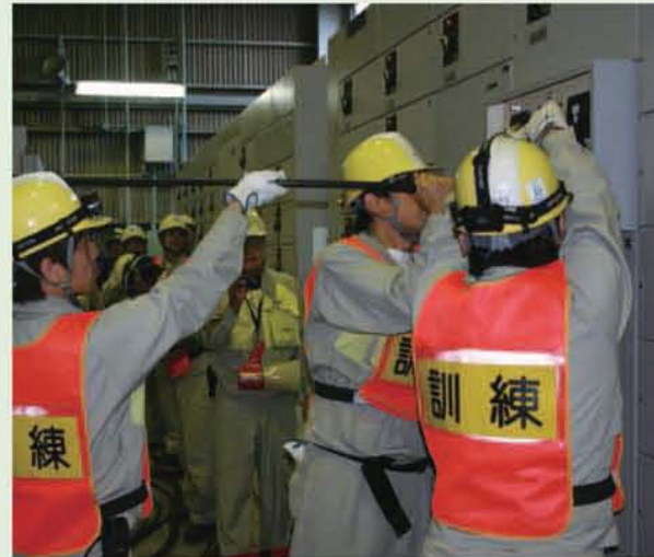
所内電源盤への電源ケーブル接続訓練(日中の訓練)
