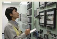
24時間体制の運転・監視 日常のパトロール
