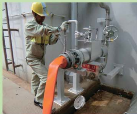
② 送水専用配管繋ぎ込み訓練
