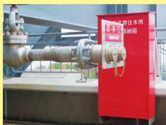
使用済燃料プールへ 給水専用配管接続口
