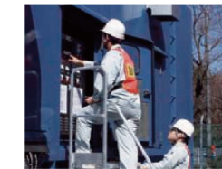
高圧電源車の起動訓練
