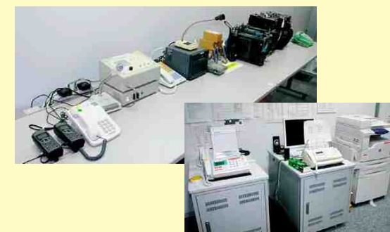
公衆回線が使用できない場合に備え、 衛星回線等を配備
