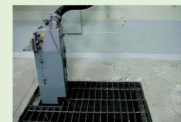
漏えい検知器の設置(例)
