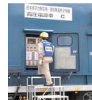
高圧電源車起動訓練
