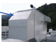
非常用発電機 (緊急時対策室建屋屋上)
