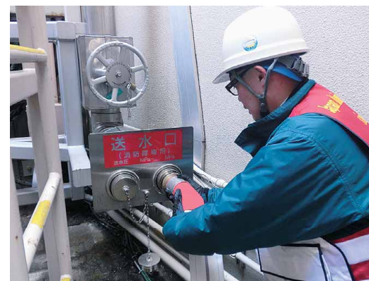
専用配管へのホースの接続
