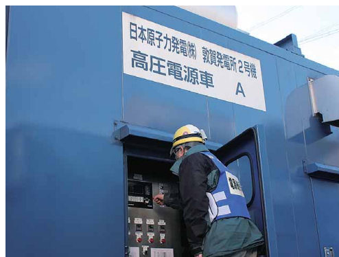
高圧電源車の起動
