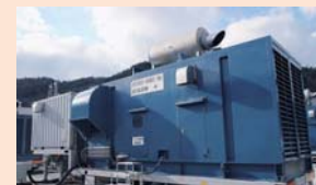
空冷式非常用発電機
