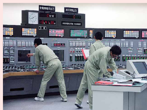
原子炉の緊急停止を伝える警報が発報し、初動対応操作を実施
