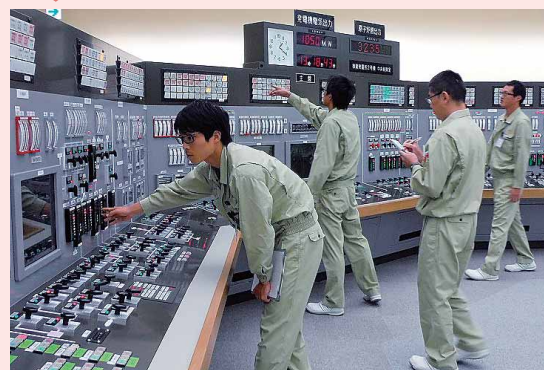
運転手順書を遵守した確実な停止操作とプラント状況の確認
