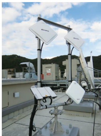
衛星電話用アンテナ(屋上に設置)
