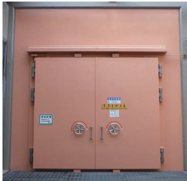
水密扉（閉止状態）
