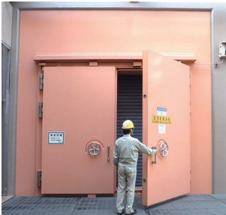
水密扉（開放状態）
