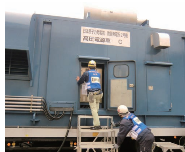
高圧電源車の起動訓練
