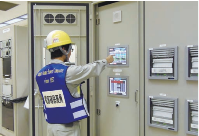
高圧電源車の遠隔起動操作訓練
