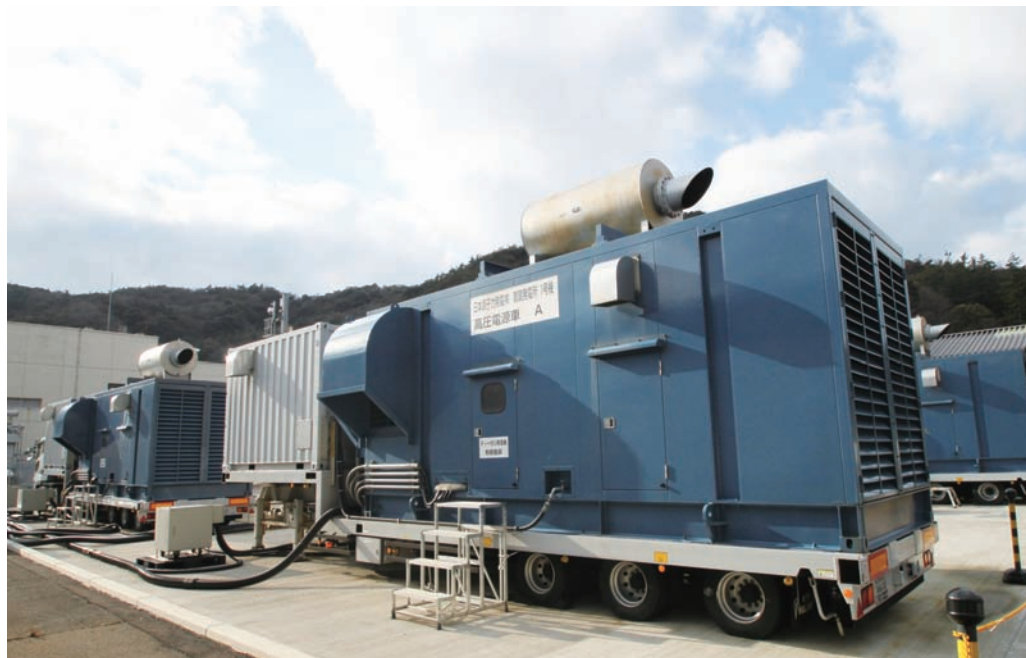
空冷式の高圧電源車
