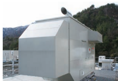
非常用発電機(屋上に設置)
