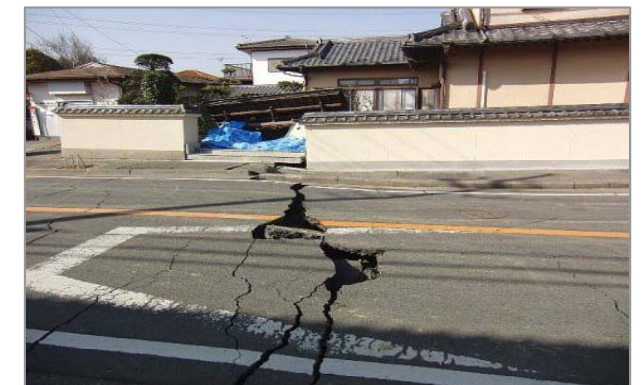
村内地震影響（家屋，道路）
