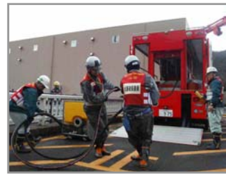
大容量ポンプ車から 冷却水を注水
