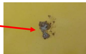
錆の拡大写真
