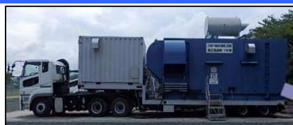
常設代替高圧電源装置
