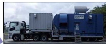
常設代替高圧電源装置 (空冷式発電機からの電源供給)
