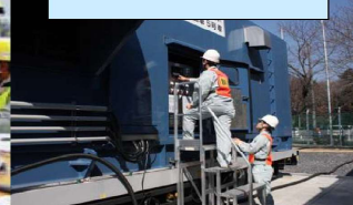
高圧電源車起動操作
