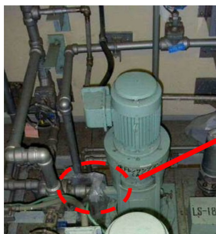
【床ドレンサンプポンプ出口配管漏えい箇所】
