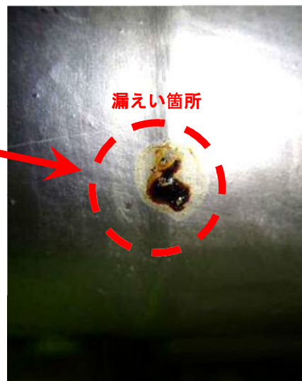
【高電導度ドレン系配管拡大写真】
