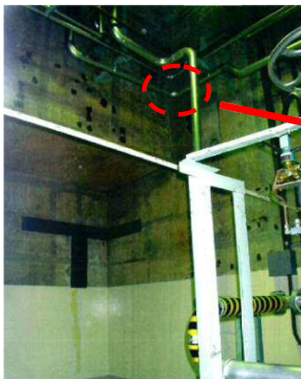
【高電導度ドレン系配管漏えい箇所】
