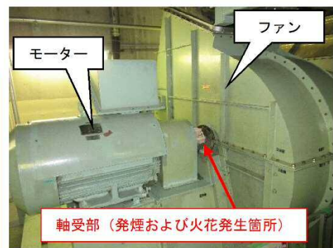
タービン建屋2階ファンルーム （原子炉建屋主排気ファンB）
