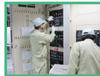
計測制御訓練室での計測制御設備盤機器点検実習
